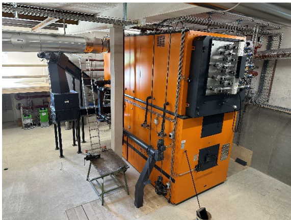
Vorher: 1 grosser Ofen/Kapazität 1200 kW kW
